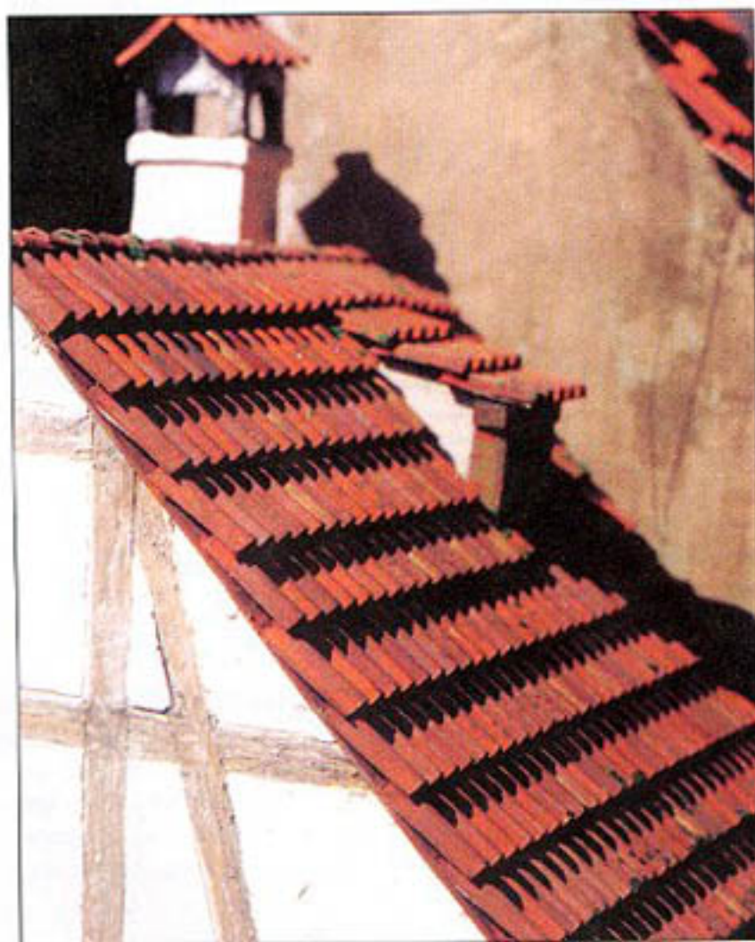
Рис. 123. Старая кровля: каждая черепица имеет свой оттенок, кое-где, у водосточного желоба больше, зеленые бугорки мха. Фрагмент здания фахверкового стиля, характерного для западноевропейских городов
